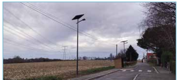
Éclairage public solaire à Saint-Armou
